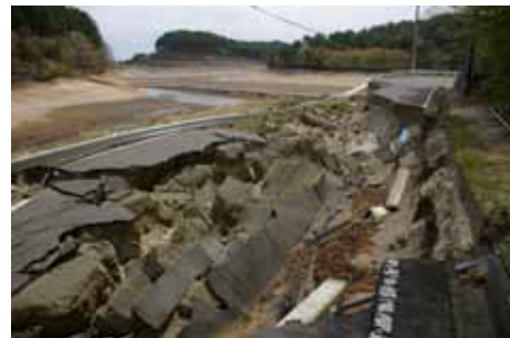
----- 藤沼貯水池のダム崩壊
