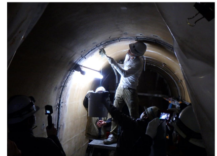
対策工法(アクリル系二成分合成樹脂系止水材注入)施工状況
