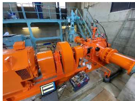
ポンプ振動診断
