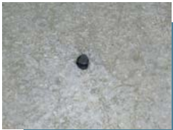
ゴム栓突出状況
